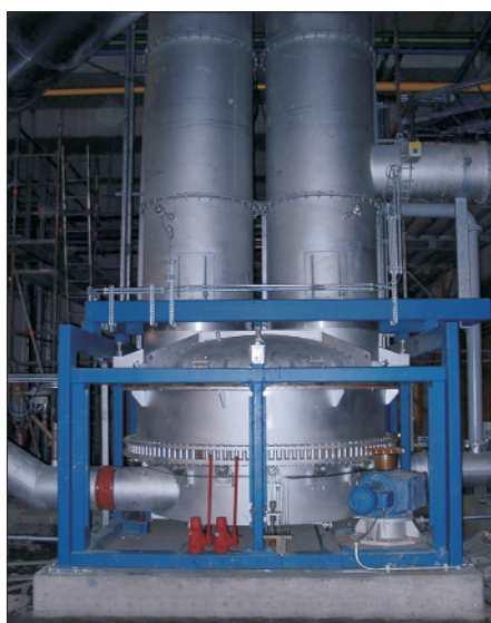
Bild 2: EcoReg®-Drehbettregenerator an einem Pyrolyse-Ofen (ConTherm) Fig. 2: EcoReg® rotary bed regenerator on a pyrolysis kiln (ConTherm)
